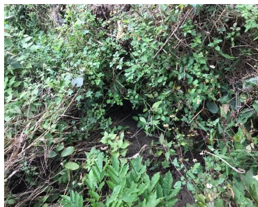
Kênh tưới thôn Lập Bình bị sạt lở, vùi lấp không dẫn được nước tưới
