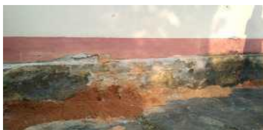
Nhà trạm có nền xuống cấp
