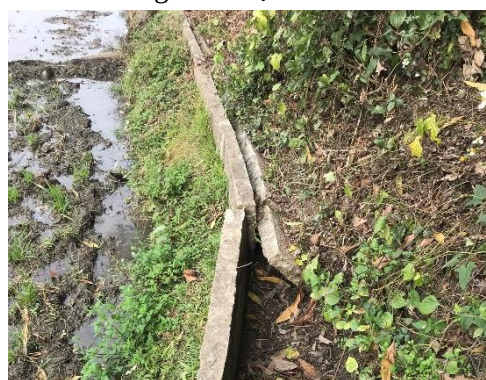
Kênh tưới thôn Lập Bình bị sạt lở, đứt gãy không dẫn được nước tưới
